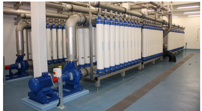
Usine de filtration du Petit-St-Bernard
